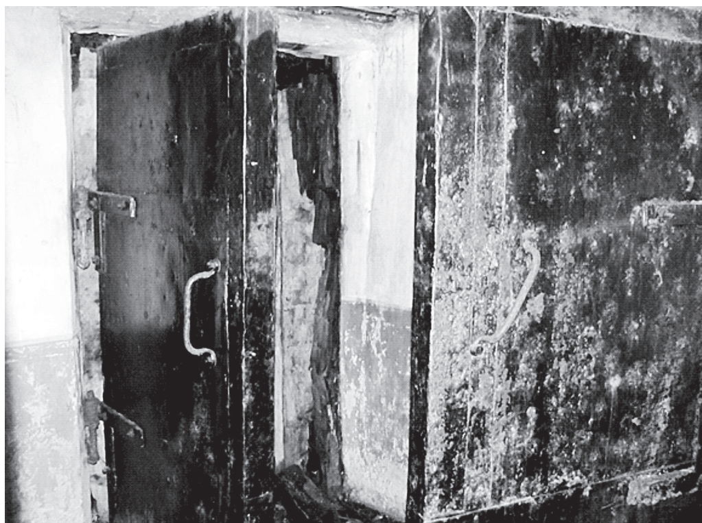
Силовая станция. Двери внутренних помещений. Фото С.В. Киреева.
