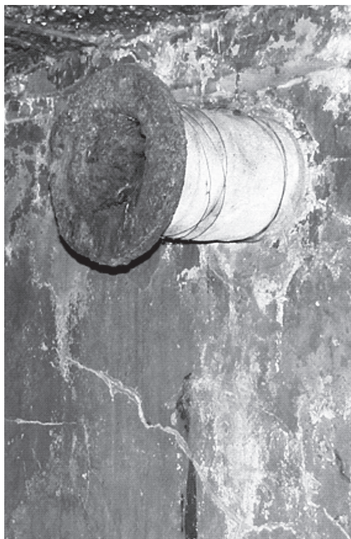
Силовая станция. Выхлопная труба дизель-генератора. Фото С.В. Киреева.
