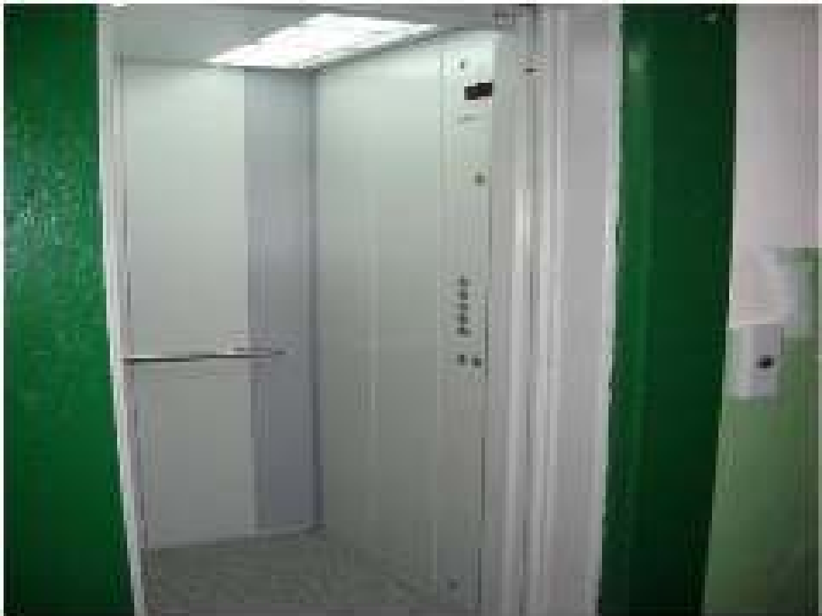
Залета лифта по ул. Мира, д. 50/20 (кула кабели), фото 3.
