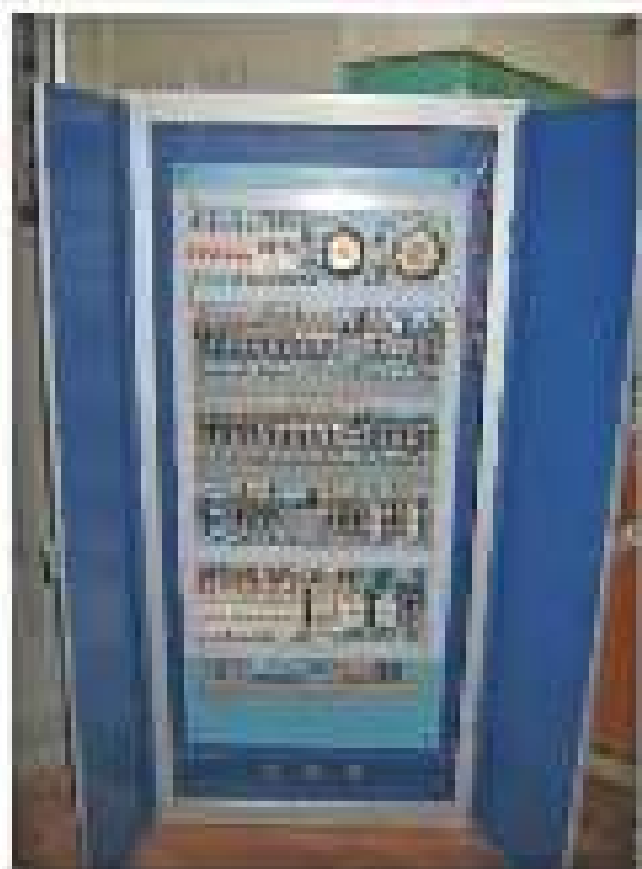
Стенд для проверки лифта ШК-5903 для проверки и ремонта плат лифта. фото 6.
