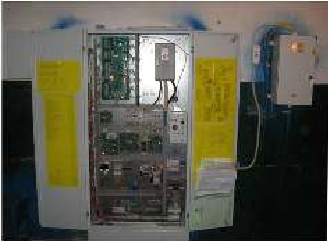
Залета лифта по ул. Мира, д. 50/20 (станция управления), фото 4.
