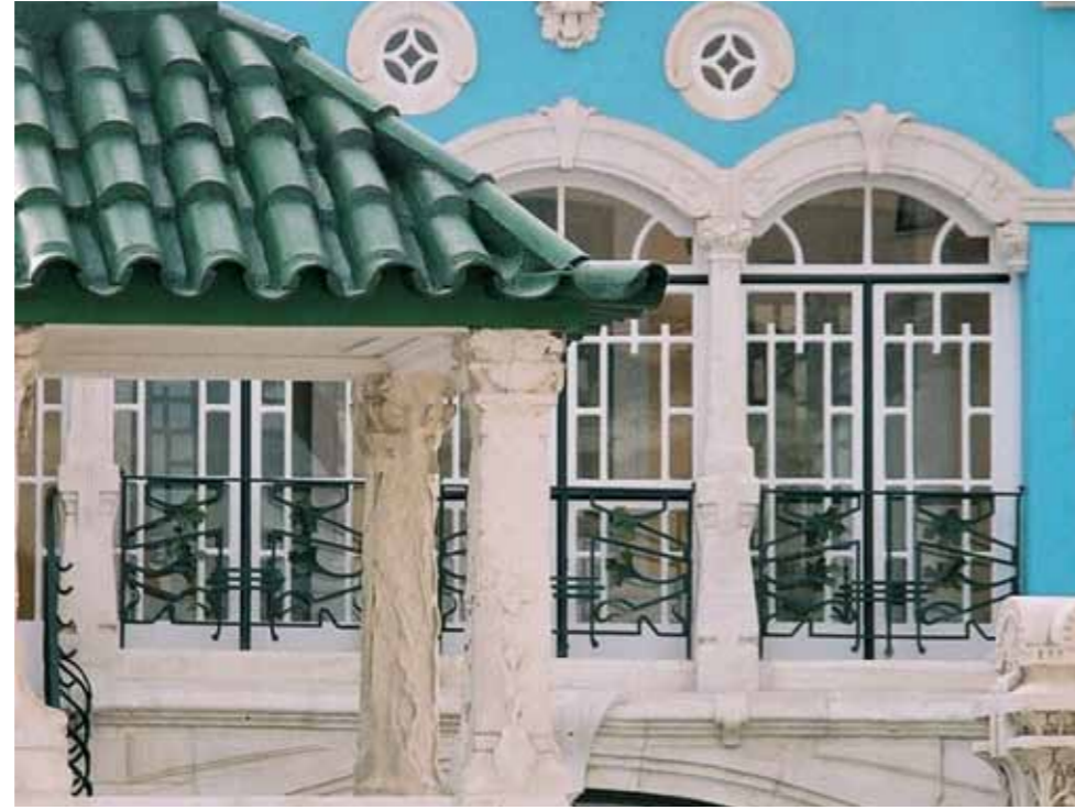
Partial view of the Arte Nova Museum's rear façade Vista parcial de la façana posterior del Museu Arte Nova
