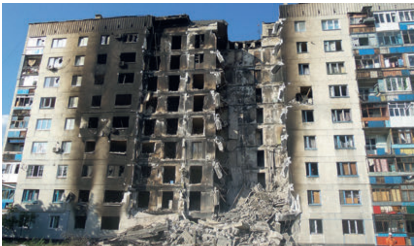
Военный конфликт на востоке Украины. Жилой дом в Лисичанске Луганской области, разрушенный в ходе войны в Донбассе 4 августа 2014 года. Источник – Wikimedia Commons. Автор - Ліонкінг
