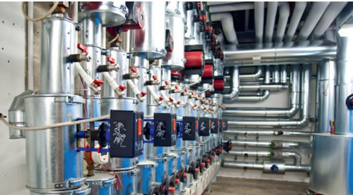
Fernwärme Hausanschluss, Quelle: Ashkan Nasirkhani, fotolia.de
