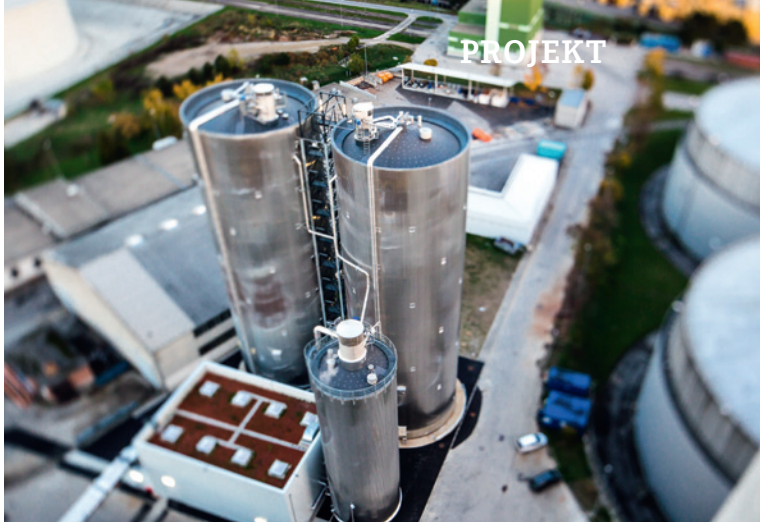
Hochdruck-Wärmespeicher am Gelände des Kraftwerks Simmering, Quelle: Wien Energie/Ian Ehm
