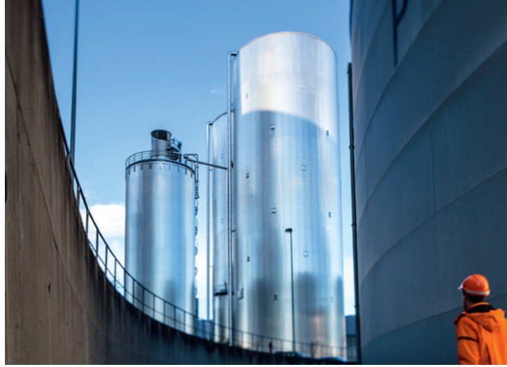
Hochdruck-Wärmespeicher am Gelände des Kraftwerks Simmering, Quelle: Wien Energie/Ian Ehm
