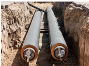
Fernwärmeleitungen, Quelle: fefufoto, fotolia.de
