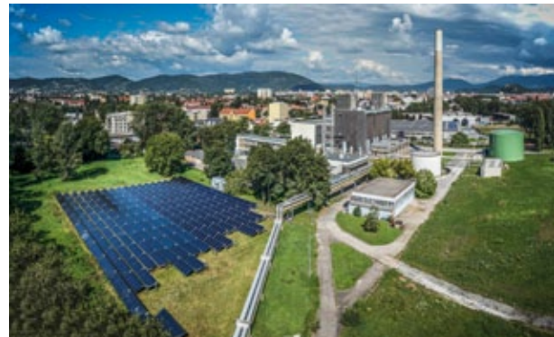
Im Jahr 2014 installierte Solarkollektorfläche (2.480 m 2 ) auf dem Gelände des AEVG-Fernheizwerks Graz, Foto: S.O.L.I.D.
