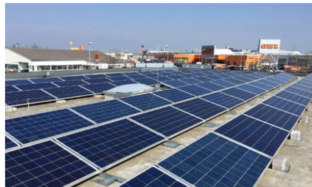
PV-Anlagen am Supermarkt in Neusiedl am See, Foto: IEV AG
