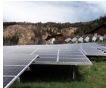
PV-Module in den Alpen/Obervellach Foto: ENcome Energy Performance GmbH
