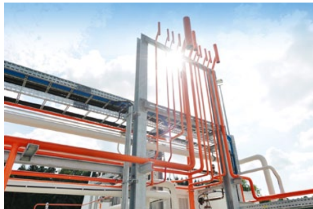
RAG Anlage in Pilsbach/Oberösterreich, Foto: RAG/Steve Haider
