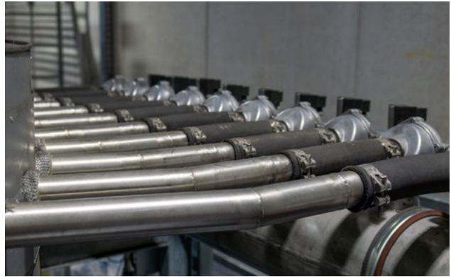
Holzgas-KWK-Anlage: Holzgasaufbereitung mittels Heißgasfiltration, Foto: BEST / Lagler
