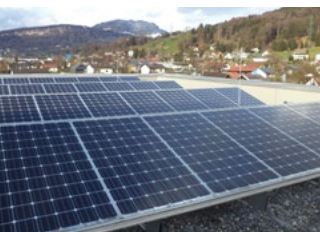
PV-Anlage Volksschule Wolfurt Mühle/Vorarlberg, Foto: AEE INTEC/Armin Knotzer
