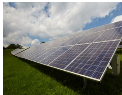
Fotos li. und re.: Klima- und Energiefonds/Hans Ringhofer, Mitte: Montanuniversität Leoben/Lehrstuhl für Verfahrenstechnik des industriellen Umweltschutzes/Croce & Wir
