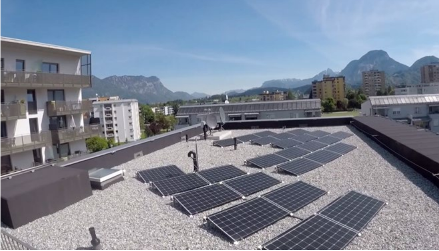
PV-Anlage mit 29 kWpeak Leistung auf den drei Dächern des ersten Bauabschnitts. Weitere 40 kWpeak Leistung sind für den 2. Bauabschnitt vorgesehen., Foto: Stadtwerke Wörgl GmbH
