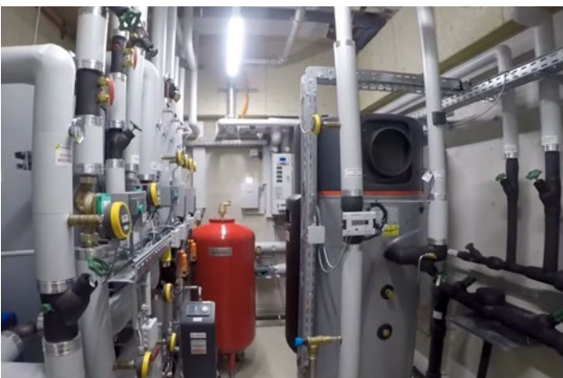
Haustechnikraum mit Wärmepumpe, Foto: Stadtwerke Wörgl GmbH
