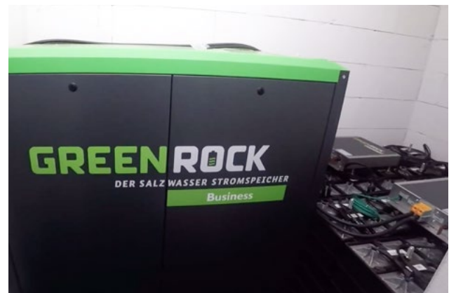
Salzwasser-Batteriespeicher mit 40 kWh Speicherkapazität, Foto: Stadtwerke Wörgl GmbH
