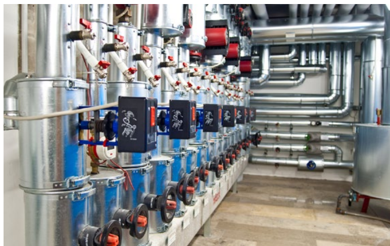
Fernwärme Hausverteiler, Foto: stock.adobe.com
