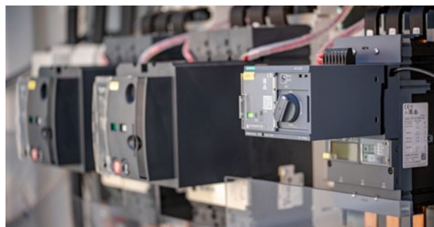
Steuerungen in einer intelligenten Ortsnetzstation, Foto: AIT / Oleksandr Melynk
