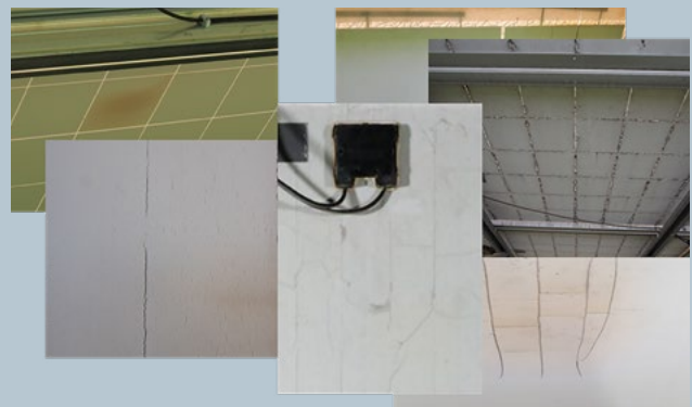
PV-Module mit defekten Rückseitenfolien, Foto: OFI
