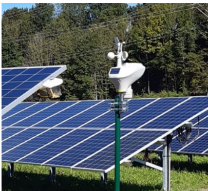
PV-Anlage und Sensor, Foto: Silicon Austria Labs GmbH
