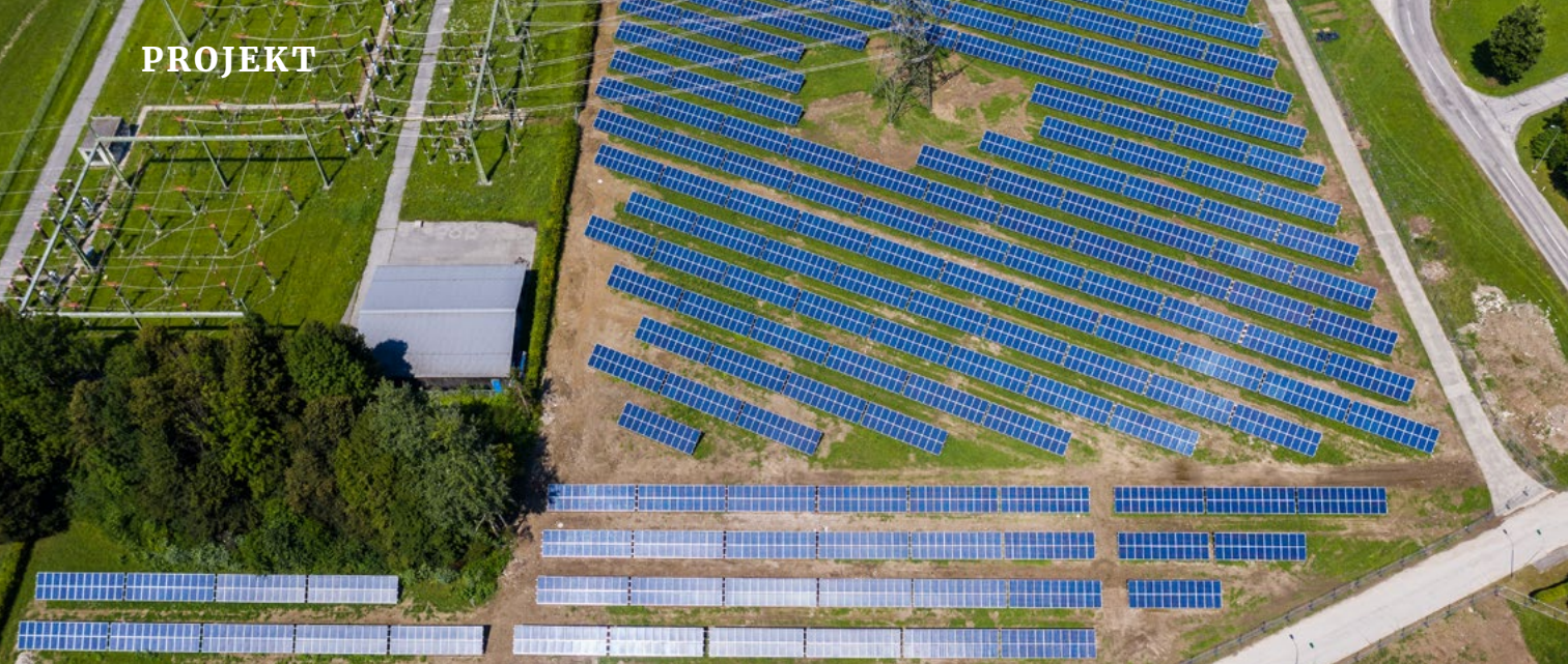
PV-Anlage in Feistritz, Foto: Verbund AG
