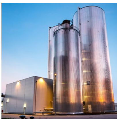
Hochdruck-Wärmespeicher Fernwärme Wien, Foto: Wien Energie/Ian Ehm
