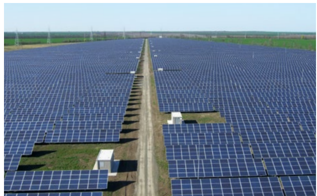
PV-Großanlage, Foto: AIT/T. Krametz
