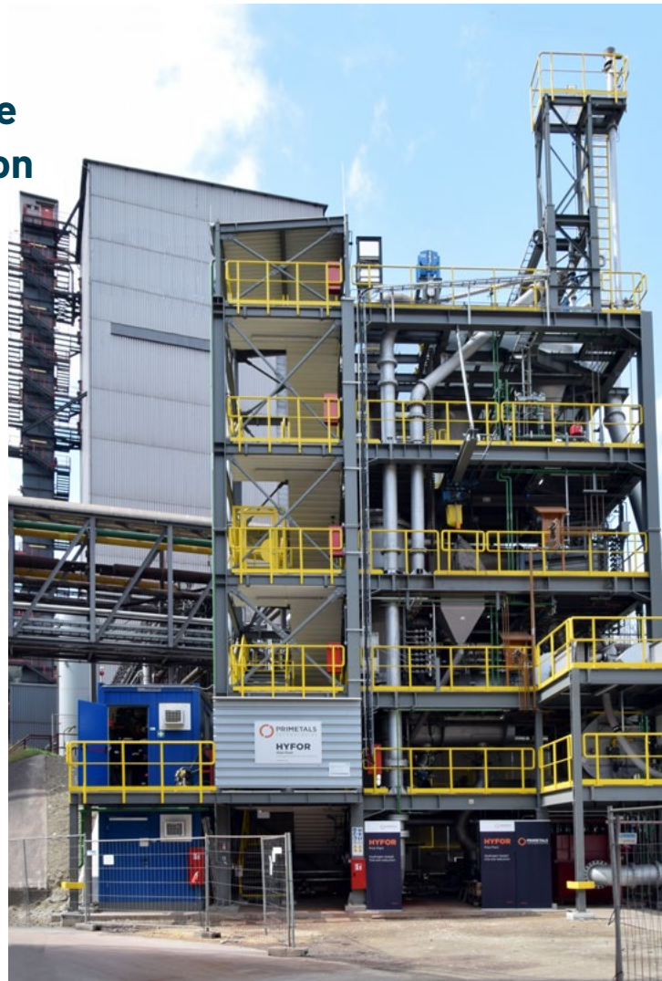
HYFOR ® Pilotanlage, Foto: primetals.com
