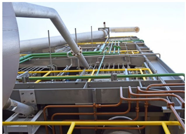
Ausschleuseleitung zum Produktkühler, Foto: primetals.com
