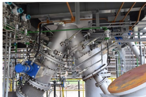
Erzchargierung Reaktor und Zyklonkreislauf, Foto: primetals.com
