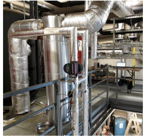
Die Gebäude werden über ein zentrales Wärmeerzeugungs- und Verteilsystem mit regionaler Biomasse beheizt: Pellets-Anlage mit 350 kW sowie Abgasrückgewinnung von 22 kW. Dadurch wird zusätzlich Energie von 63 MWh/Jahr gewonnen, dies entspricht dem Wärmeenergie-Bedarf von 10 Wohnungen. Die Pellets-Anlage übernimmt bis zu 92 % des Wärmebedarfs. Auch die Abwärme, die bei der Kühlung der Büros sowie bei der Belüftung von 22 Wohneinheiten entsteht, wird genutzt. Für die Bedarfsspitzen steht ein effizienter Gasbrennwertkessel mit einer Leistung von 400 kW bereit. Foto: SIR
