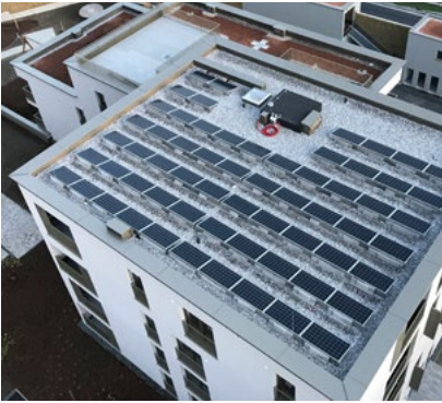
Photovoltaikanlage mit einer Gesamtleistung von 140 kWp. Der tagsüber erzeugte Strom kann von allen Bewohner:innenn mittels dynamischer Berechnung aufgeteilt und direkt genutzt werden. Foto: SIR
