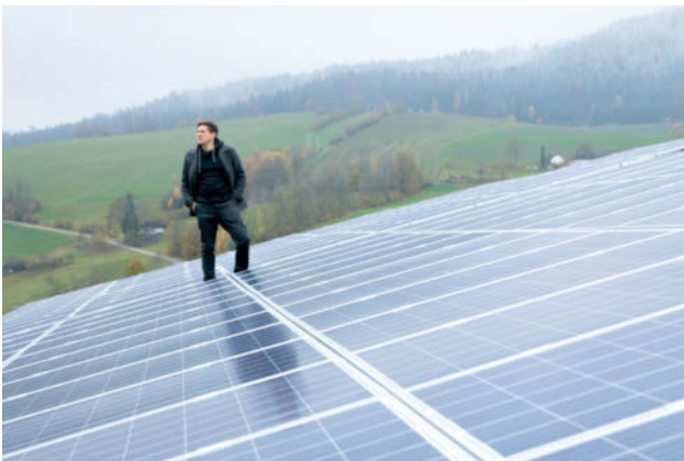
Markus Altenhofer auf dem Dach der Europaschule Peilstein: Innerhalb der letzten Jahre wurden 33 Photovoltaik-Anlagen in der KEM installiert.
