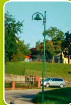
Energieeffiziente Straßenbeleuchtung in der KEM Schmidatal
