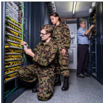
Installations de réseaux pour le transfert de données
